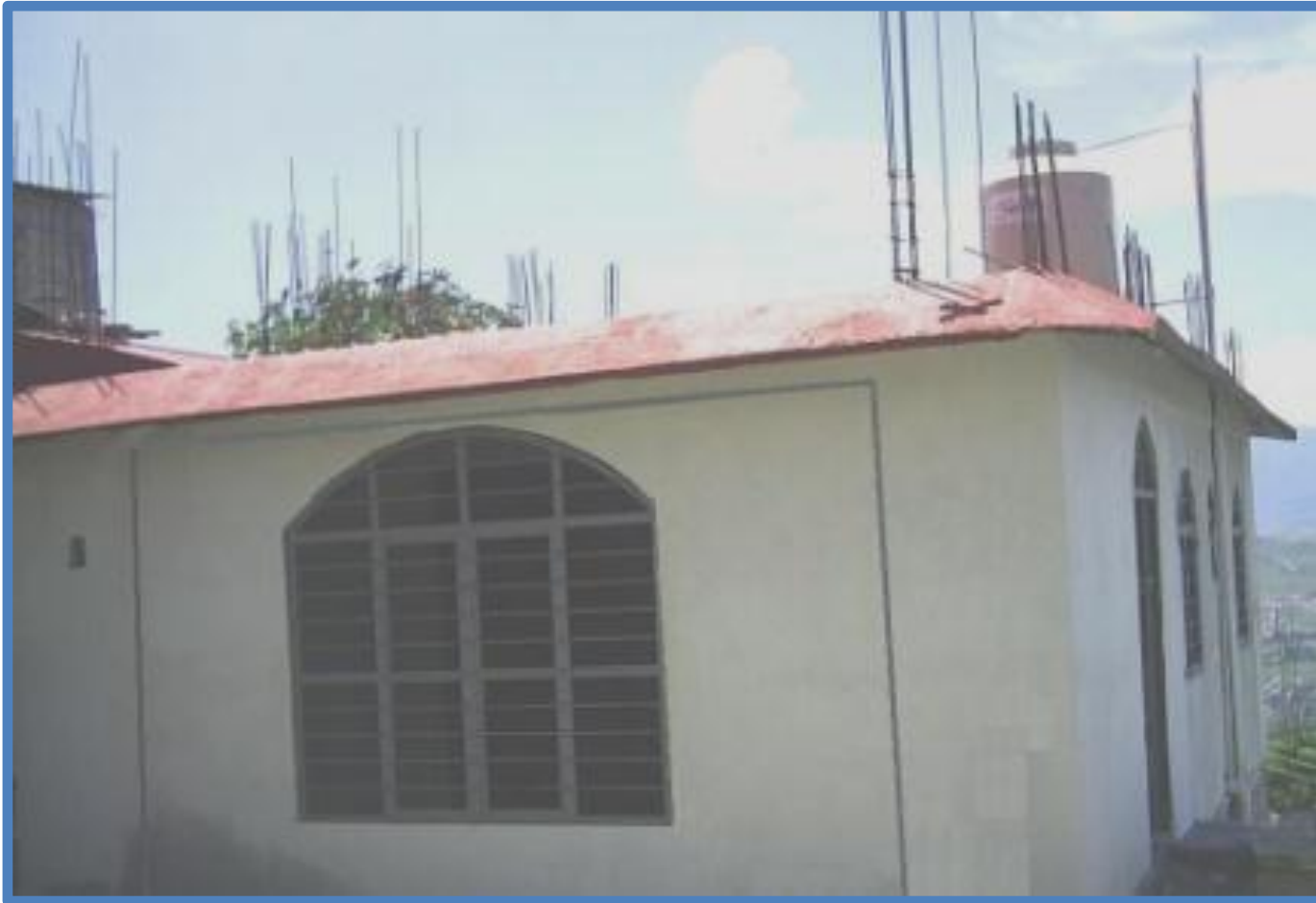
FOTOGRAFIA 21, VIVIENDA CON APLANADO FINO.
